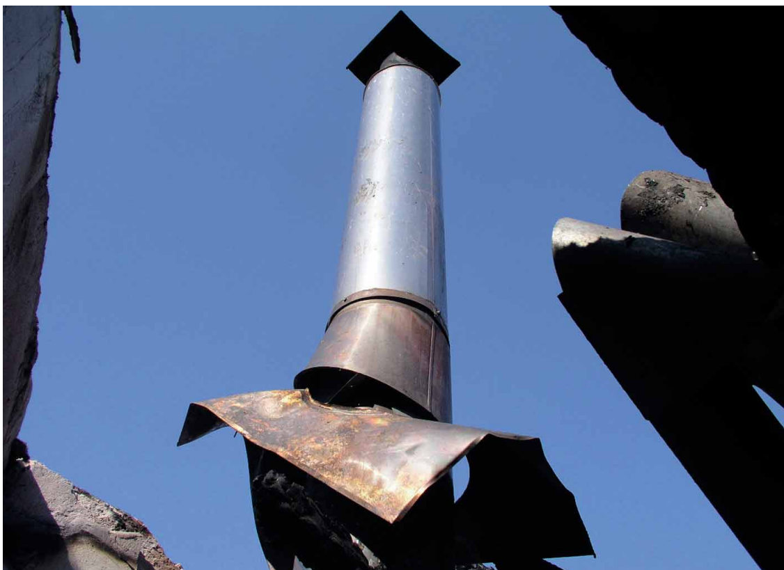
Złe wykonanie, brak przeglądów i konserwacji kominów może skończyć się tragedią. [Fot. Stowarzyszenie „Kominy Polskie”]
